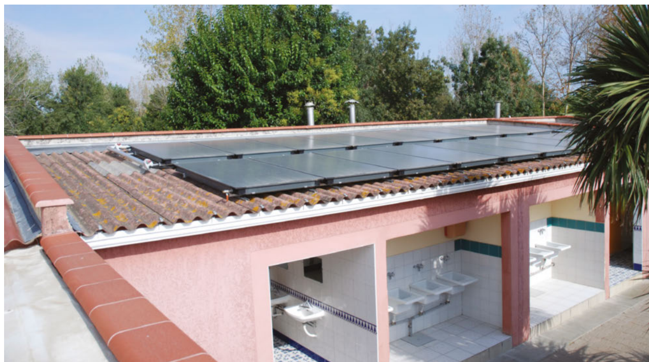
Le solaire thermique permet de chauffer l'eau chaude sanitaire, mais également l'eau des bassins des parcs aquatiques.
